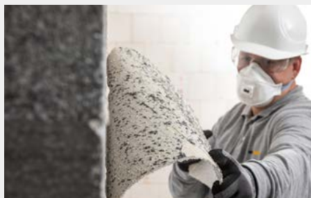
2. Desconchado del sistema de revestimiento
