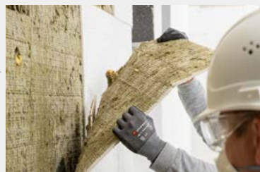
2. Despegado del revestimiento
