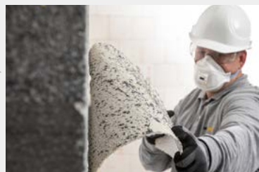
2. Despegado del revestimiento
