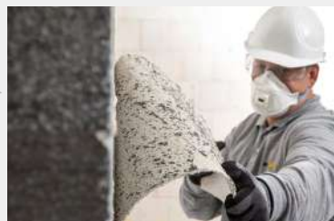
2. Despegado del revestimiento
