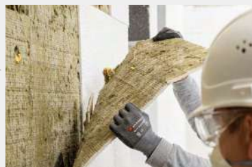
2. Despegado del revestimiento
